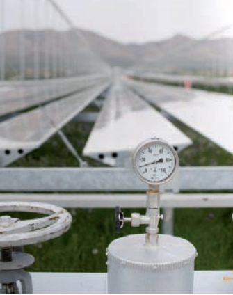
TÜV SÜD ha realizado un seguimiento a una central experimental con tecnología Fresnel en Puerto Errado, desde la planificación hasta la puesta en marcha.
